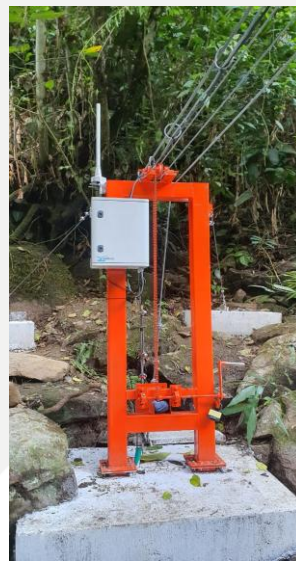
Torre Orilla derecha, gabinete y estación de radio para transmisión de datos
