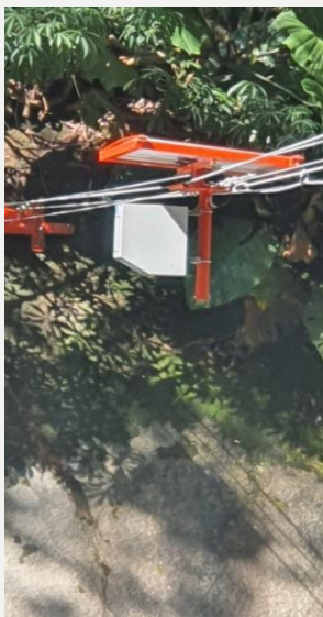
Anclaje a roca orilla izquierda. Cableado, Equipo de medición y panel solar.
