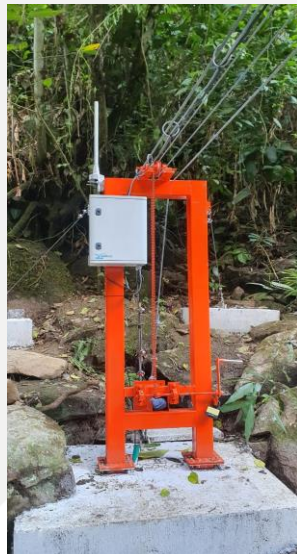
Torre Orilla derecha, gabinete y estación de radio para transmisión de datos
