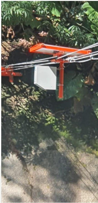
Anclaje a roca orilla izquierda. Cableado, Equipo de medición y panel solar.
